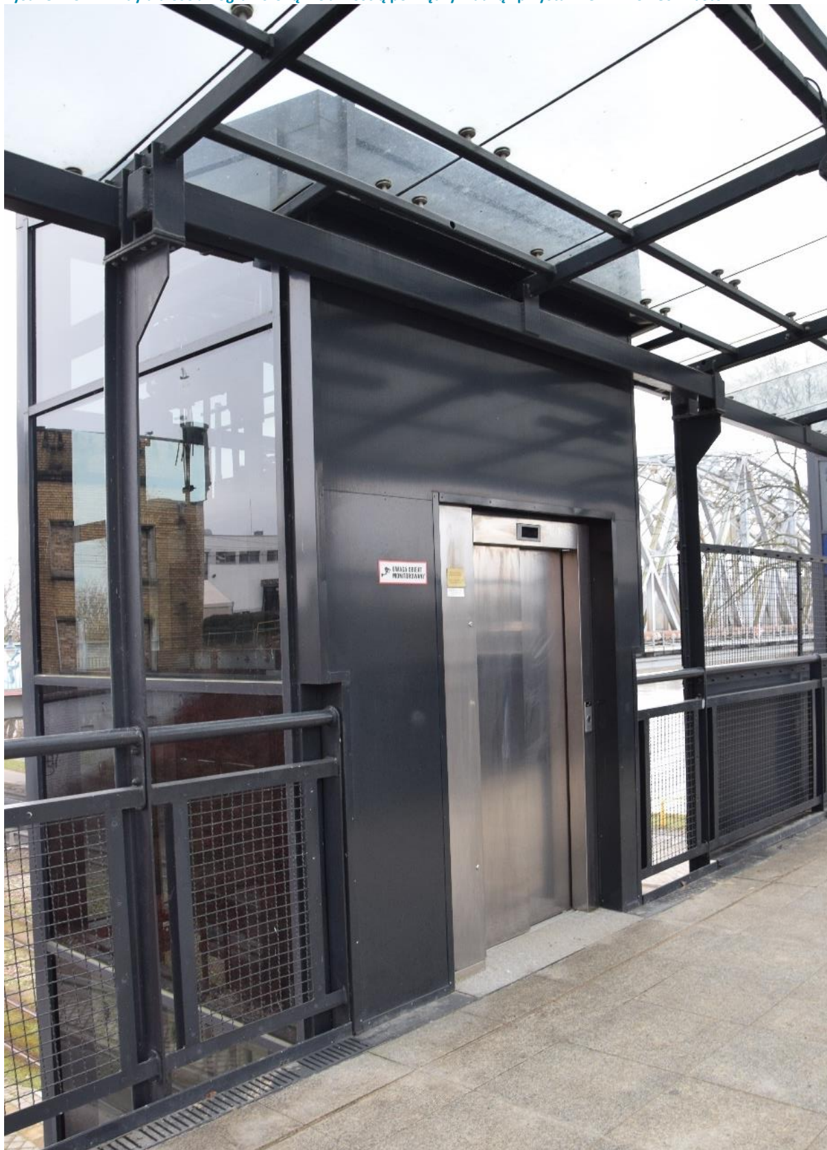
Rysunek 137. Windy dla osób z ograniczoną mobilnością pomiędzy kładką i przystankiem Dworzec Miasto.
