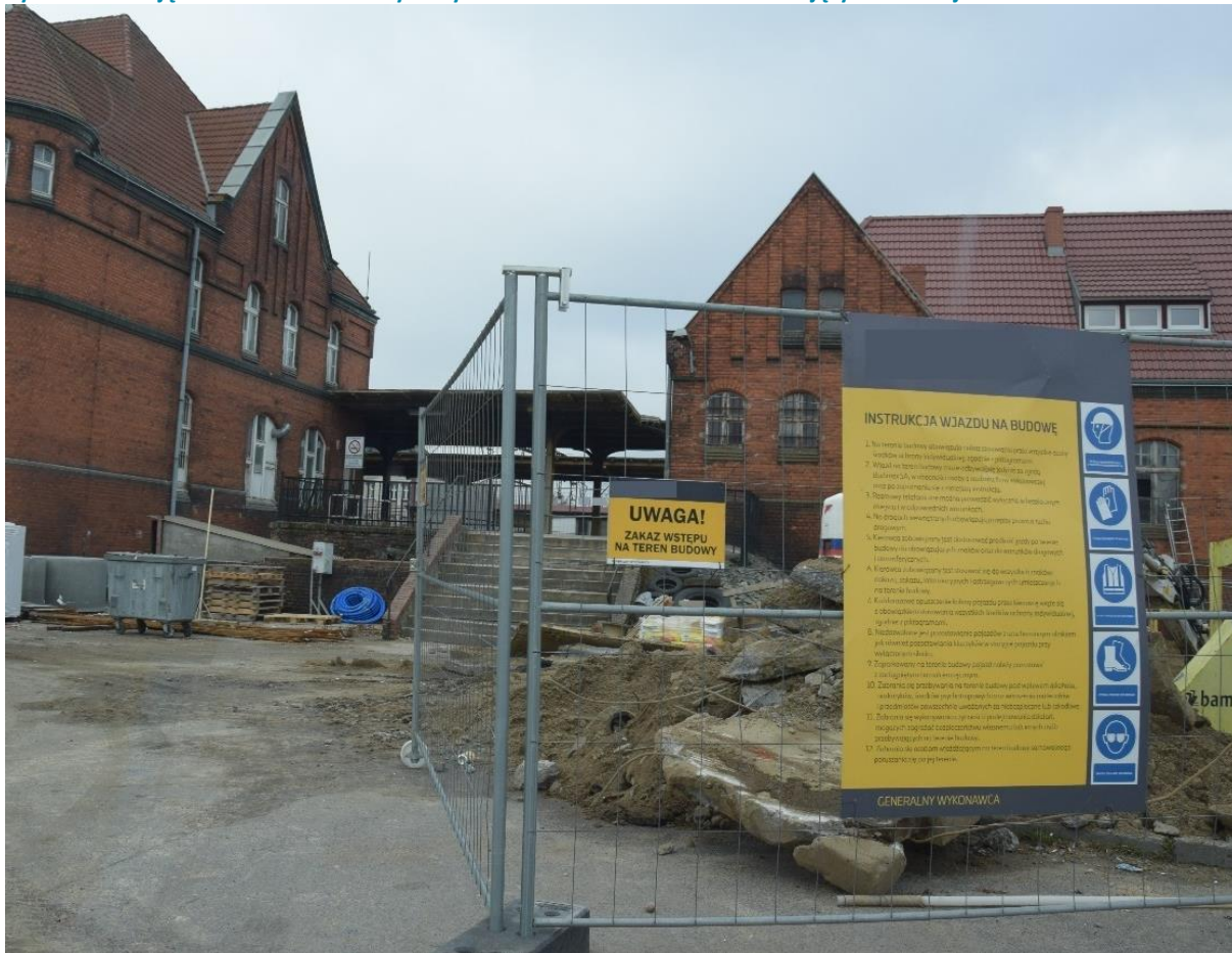
Rysunek 17. Zdjęcie na modernizowany budynek dworca wraz z terenami okalającymi na stacji Toruń Wschodni.
